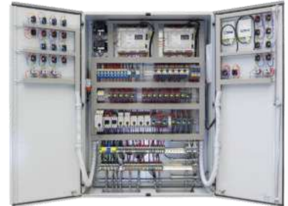
Tủ điện điều khiển của Weishaupt với hai bộ điều khiển W-FM 200
